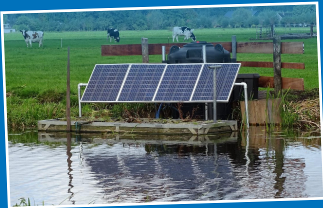
Infiltratie en peilgestuurde drainage op zonne-energie
