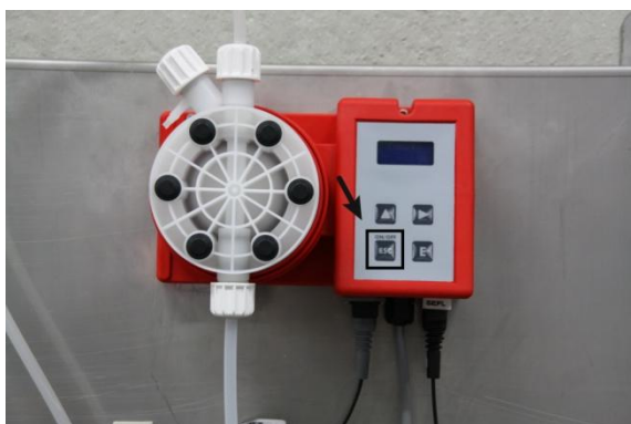
Figura 13: Avviare la pompa
