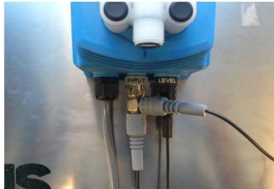
Illustration 2 : Connexion de la sécurité anti-assèchement et du débitmètre
