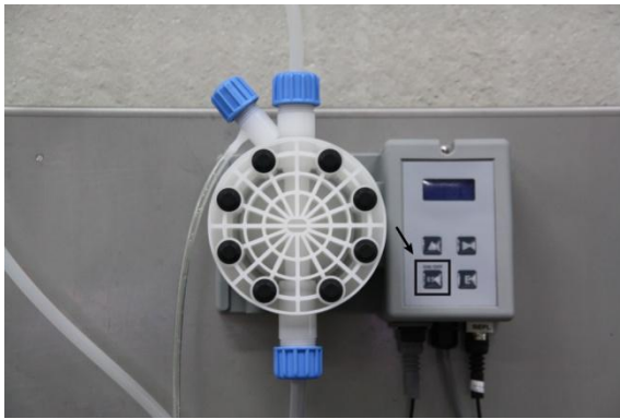
Afbeelding 5: Aanzetten van de pomp
