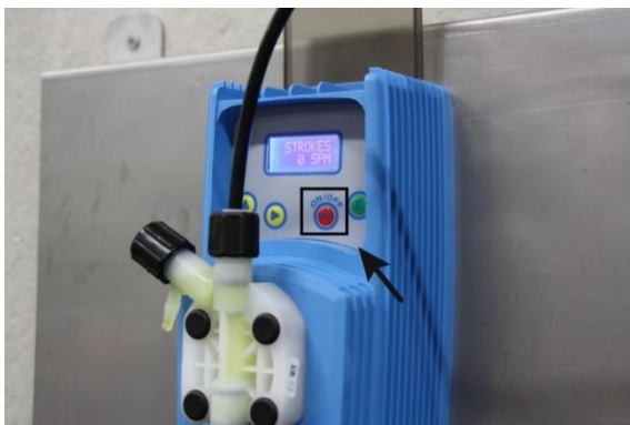
III. 5: Mettre la pompe sous tension
