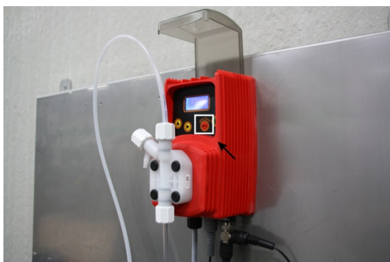
Figur 5: Tænd for pumpen
