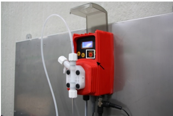
III. 5: Mettre la pompe sous tension
