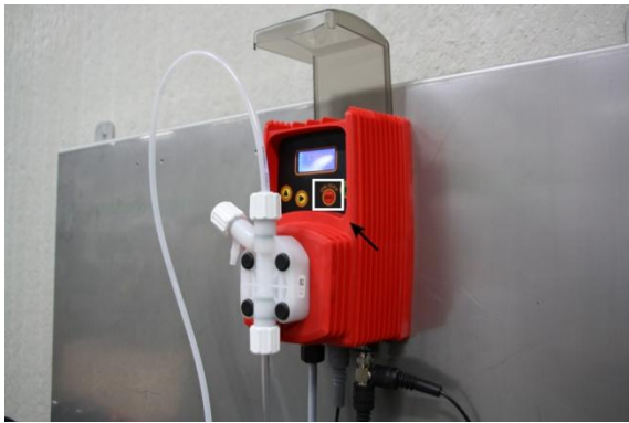
Figura 12: Avviare la pompa
