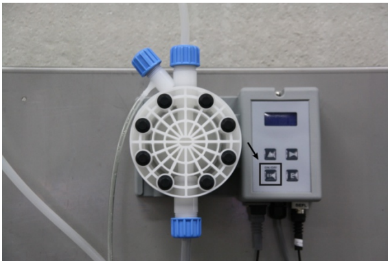
Figur 7: Tænd for pumpen
