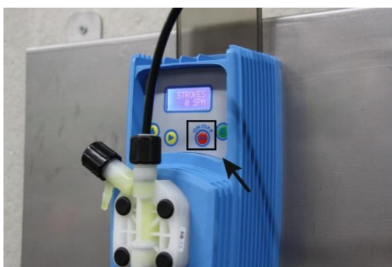
III. 5: Mettre la pompe sous tension
