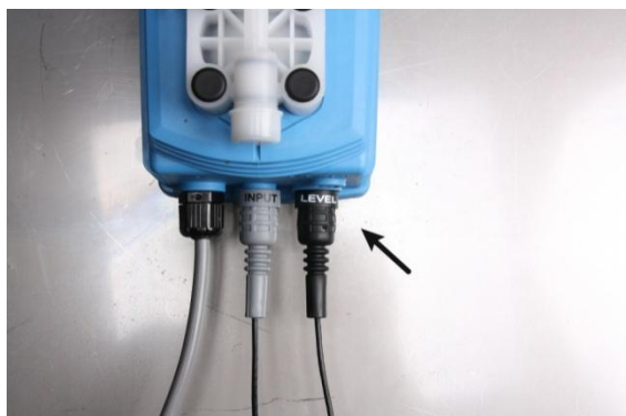
Imagen 2: Conexión de la protección contra el funcionamiento en seco y el contador de agua
