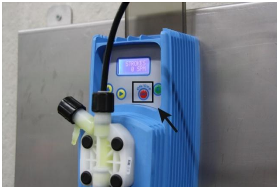
Figura 5: Avviare la pompa
