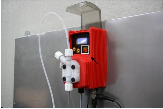
Figura 5: Avviare la pompa
